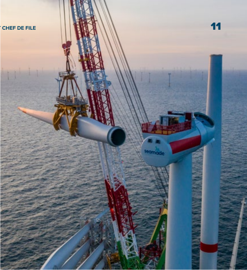
Parc éolien Seastar 30 éoliennes en mer du Nord belge
